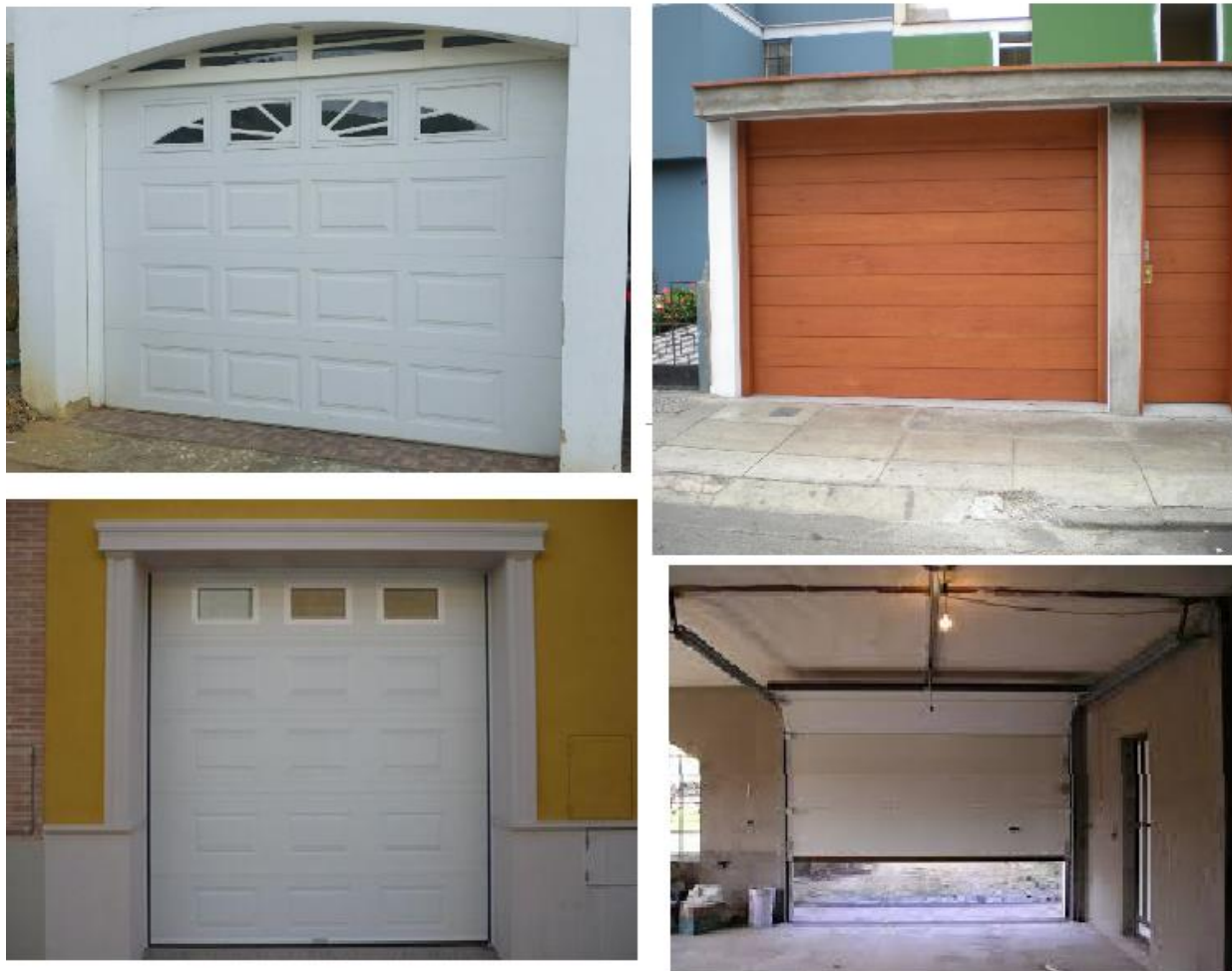
Figura 15: Instalaciones de puertas seccionales (SYSTEMS DOORS)
