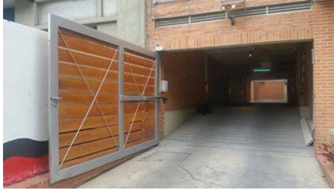
Figura 5: prueba de funcionamiento (fuente propia)
