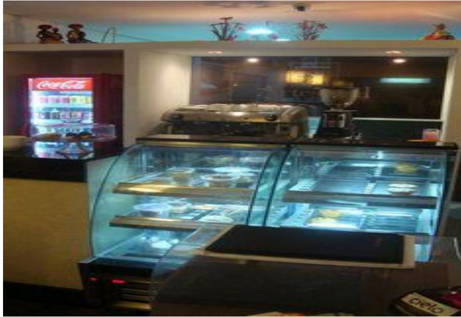
Figura 4 Refrigerador para la conservación de productos lácteos y cárnicos.
