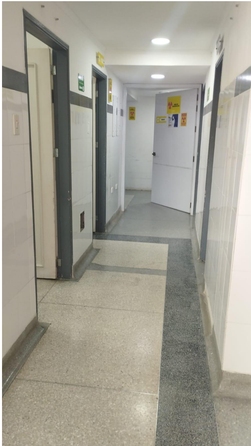
Ilustración 17 Zonas o áreas sin delimitar al igual que la altura de la señalización de ruta de evacuación no es la adecuada
