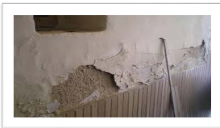
Figura 4. Daños en la mampostería y en la pintura causados por la humedad por remonte capilar.
